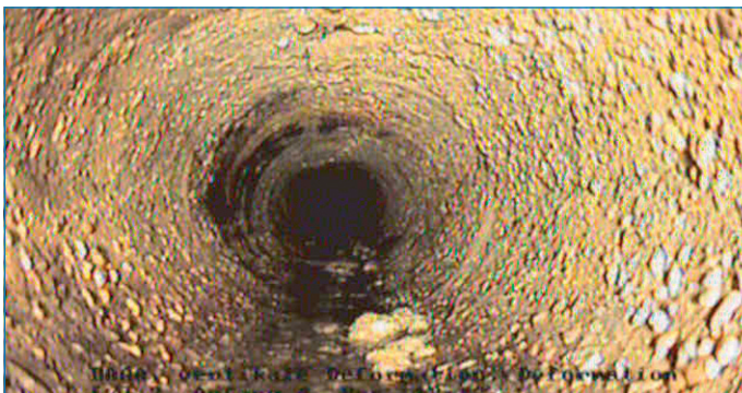
Blick in den schadhafte Kanal in der Burötherstraße im Stadtteil Wehrden, der bald erneuert wird.
